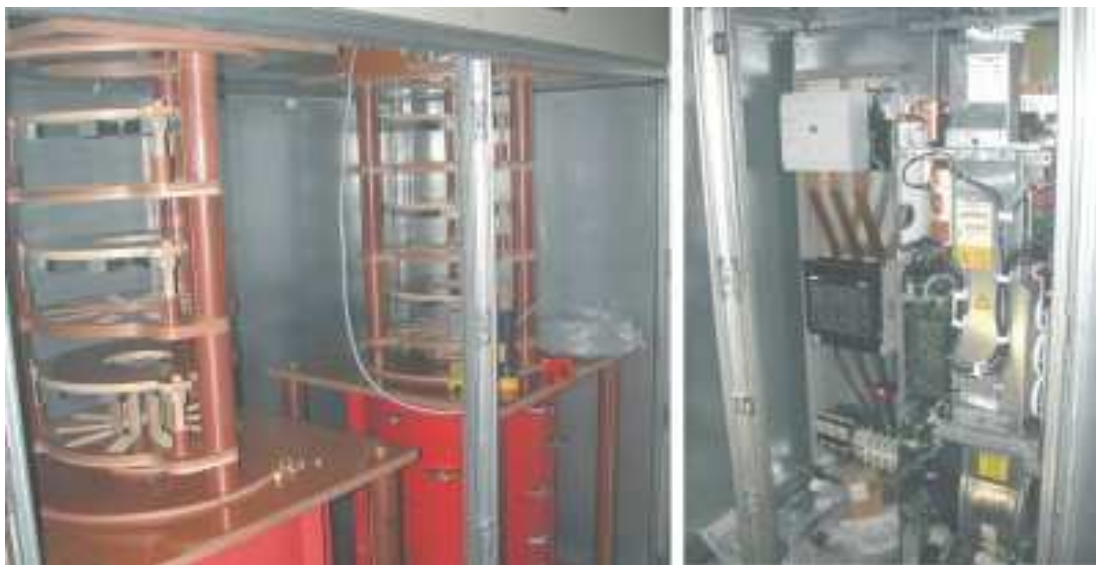
Bild 5: Blick in die Schaltschränke des Einspeisecontainers. Links der Vierpol während der Montage, rechts der Wechselrichter mit Schutz und Netzsicherungen
