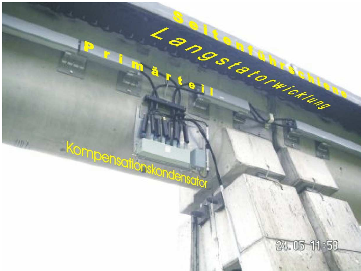
Bild 8: Fahrwegträger mit Kabelhalterung aus faserverstärktem Kunststoffprofil sowie Kompensationskondensator und Funktionsüberwachung
