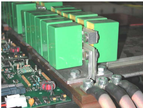
Bild 2: Kondensatorbank auf einem Hauptschalter
