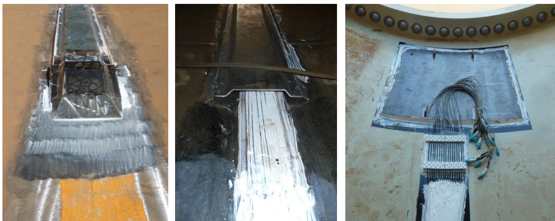
Bild 51: Rammschuh (links), Kabelbündel und Schutzprofil (Mitte), Zugentlastung und Aufhängung der Datenerfassung (rechts)
