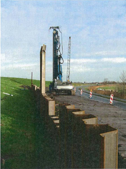
Abbildung 11: Verformter Spundwandkopf bei Deich-km 21+400
