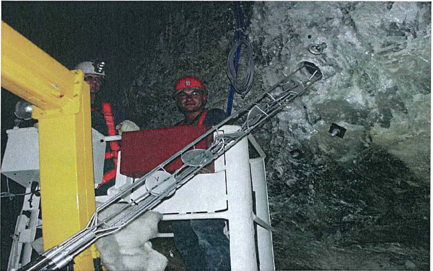
Bild 1: Installation einer Spannungsmonitorstation mit 6 Druckmessgebern
