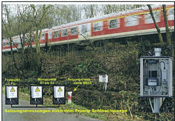
Bild 12: Setzungsmessgeräte nach dem Prinzip der Schlauchwaage mit Neigungsmessstellen am Bahndamm
