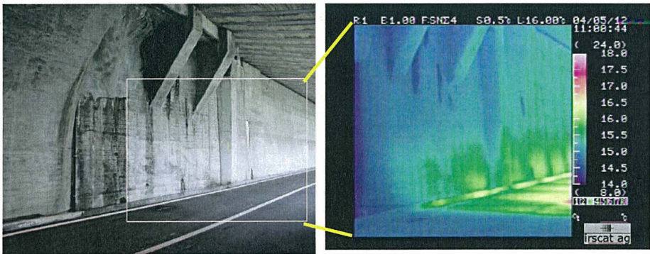
Abb. 4.16: Scheinbare Anomalie in einem Galeriebauwerk hervorgerufen durch vorausgegangene Sonneneinstrahlung im Laufe des Tages (irscat ag)
