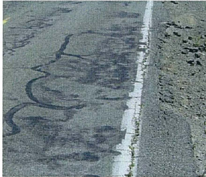
Abb. 2: Fahrbahnabplatzungen im Randbereich der Straße
