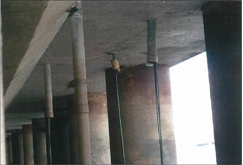
Abb. 16: abgerissene Kabelschutzverrohrung auf der Wasserseite CTA 1.BA
