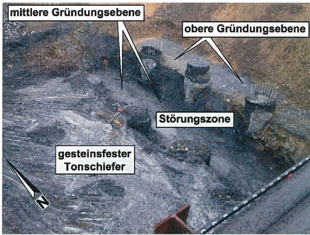
Abbildung 14: Störungszone im Bereich des Widerlagers Ost der nördlichen Brücke
