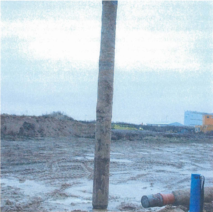
Bild 10: Aufweitungsbereich Zugpfahl RP 2
