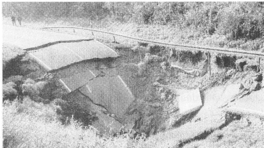
Abb. 1 Erdfall an der B180 (Mansfelder Land)
