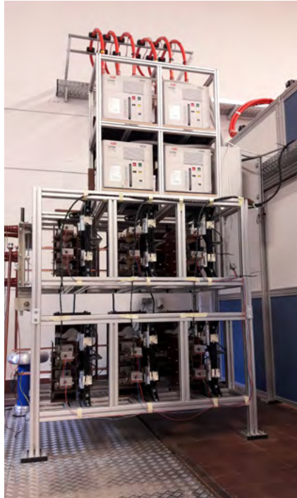
B12 GLEICHRICHTER INKLUSIVE VORGELAGERTER LEISTUNGSSCHALTER
