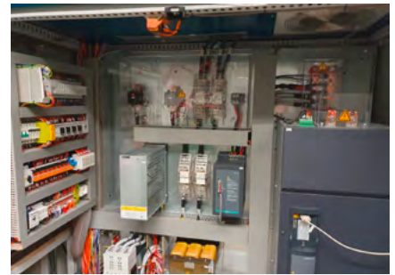
LVDC-SCHALTSCHRANK MIT LVDC-AFE & DC-SAMMELSCHIENE
