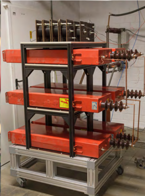
HOCHSTROM (LINKS) / HOCHSPANNUNGS- (RECHTS) KONDENSATORBANK
