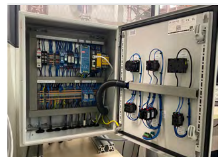
Abbildung 4: Schaltschrank von innen
