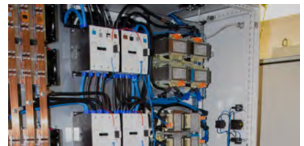
SCHRANK 1 DER AUTOMATISIERTEN NETZNACHBILDUNG
