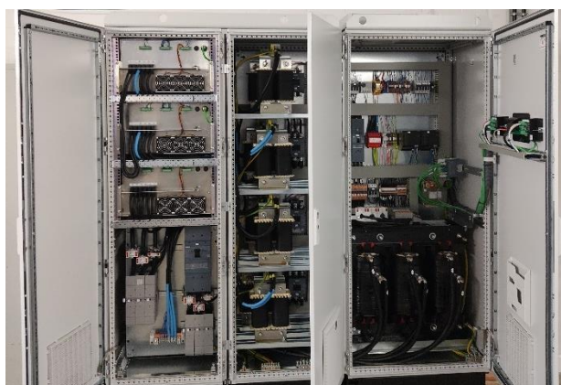
Abbildung II-88: Geöffneter Spannungsqualitätsregler in den Laboren der TU Braunschweig
