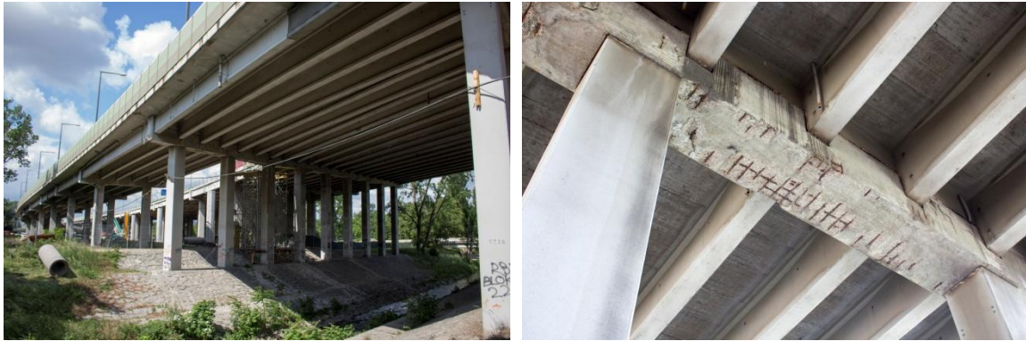
Abbildung 16. Die „Aufständigung“ der Hochstraße (li.), Schadstellen an der Hochbrücke (re.).
