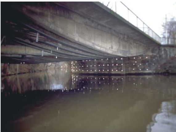
Abb. 1: Blick auf die Okerbrücke aus nordöstlicher Richtung. Deutlich erkennbar sind die Reflexfolien am westlichen Widerlager (Foto: B. Riedel).
