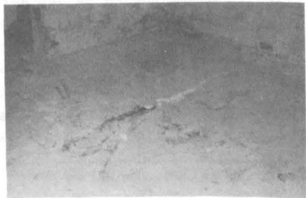
Bild 14 : Riß am Ende der oberen Bewehrung
