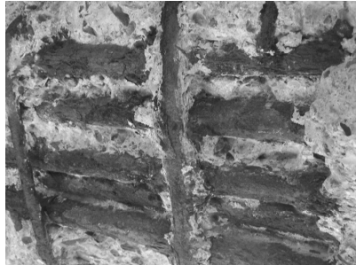
Abb. 6-2 Verdichtungsfehler aufgrund zu kleiner Stababstände
