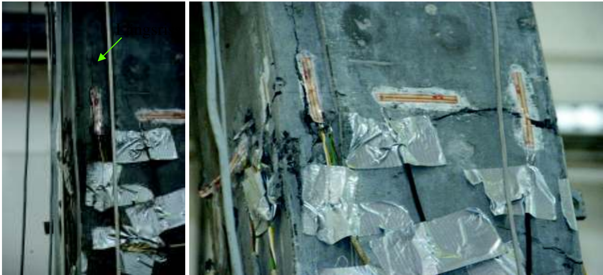
Bild H-11: C1 in Stützenmitte (Ostseite) im Nachbruchbereich bei 2000 kN: Längsriss in Stützenmitte (links) und Einschnüren der Betondruckzone (rechts)
