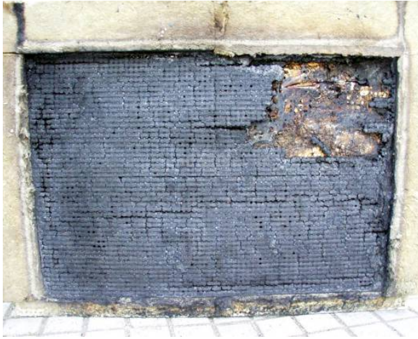
Bild 93: Ansicht des Deckenelements nach dem Brandversuch
