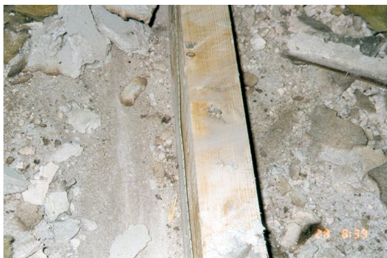
Bild 5: Zustand der Holzträger nach einem Brandversuch [8]
