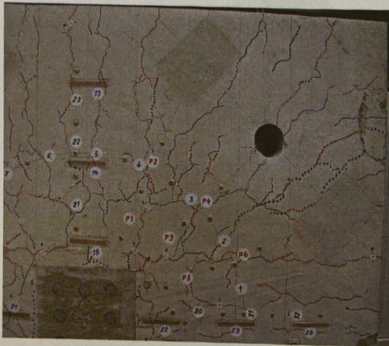
Bild 5.2.6.28 Rissbild Deckenplatte DS6 Teilausschnitt analog Bild 5.2.6.24 nach Entlastung mit sichtbaren Rissen (0,2 – 0,5 mm)
