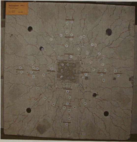
Bild 5.2.6.27 Rissbild Deckenplatte DS6 nach Entlastung
