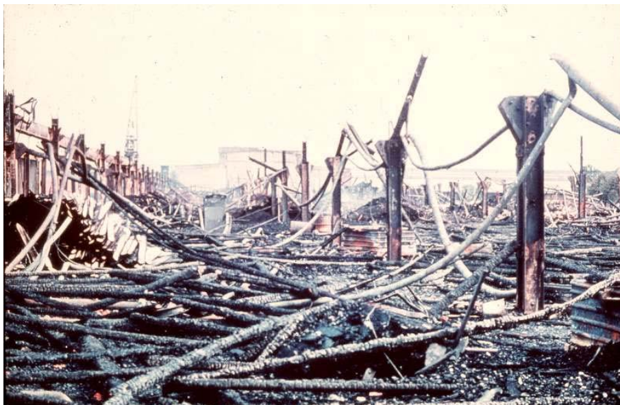
Bild 1 Stahltragwerk nach einem Vollbrand (aus [HOS03])
