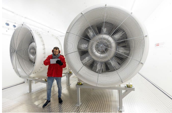
Teil des Klimarollenprüfstandes: Umluft- und Klimatechnik im Obergeschoss. Bildnachweis: NFF/André Walther
